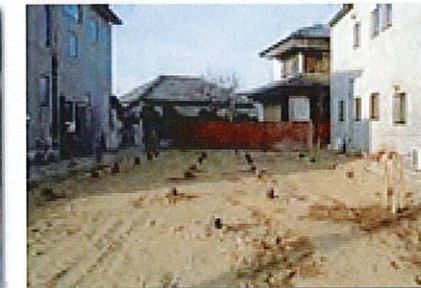
管理装置による施工管理も可能
